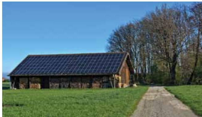
Impianto fotovoltaico su fabbricato rurale
