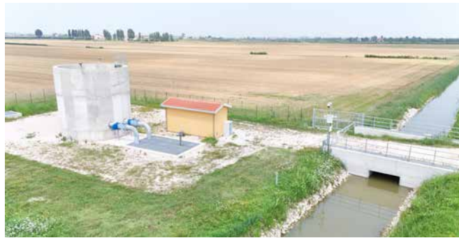
L'impianto di sollevamento irriguo Gentilini nel territorio di Porto Viro
